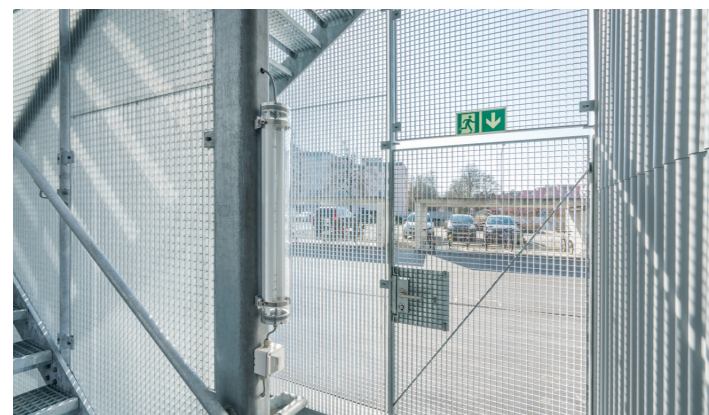
Eine Gitterrosttür mit Antipanik-Funktion gewährleistet den Fluchweg.
